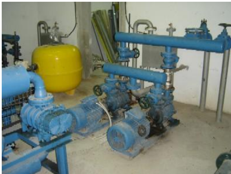
Εικόνα 5.14 Τυπική εγκατάσταση αντλιοστασίου μεσαίας ονομαστικής ισχύος
